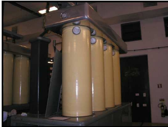
Bilden visar en kvicksilverlikriktare (jonventil), 150 kV, 950 A, tillverkad av ASEA, Västerås, i början av 1960-talet.
