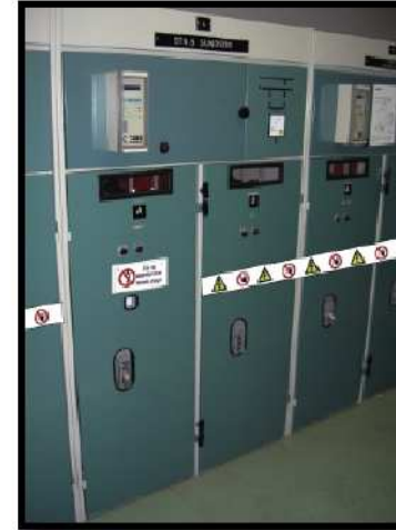
Ett ställverk med tydliga markeringar för arbete.
