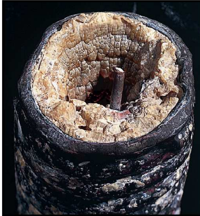
Hårt vatten som satt igen ett rör.
