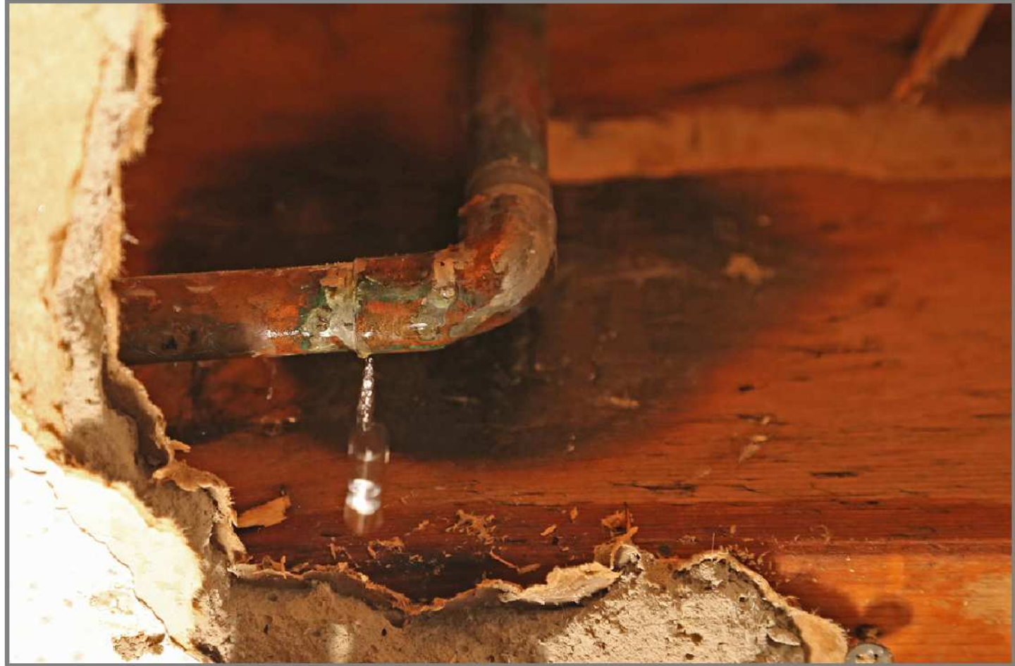
Vattenläckage kan ge stora skador.
