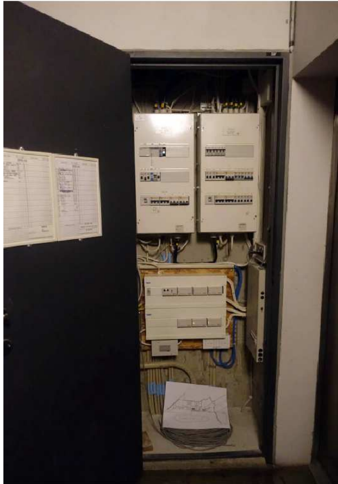
Apparatskåpet sitter bakom en helt vanlig ståldörr. Längst ner sitter ingångsmoduler.
