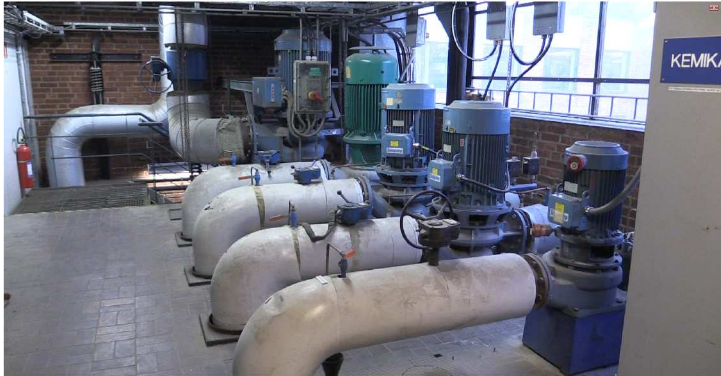
Dessa pumpar styrs av utrustningen i apparatskåpet som vi kommer att titta närmare på i nästa steg.
