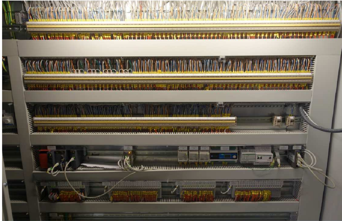
Apparatskåp på Vasamuseet. Det här skåpet används för att styra fläktarna i entréhallen och souvenirshopen.
